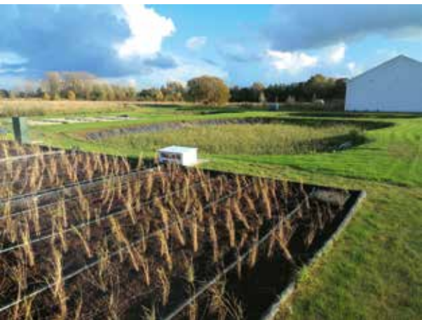
Een combinatie van beluchte en onbeluchte rietvelden moet voldoende mogelijkheden scheppen voor denitrificatie. (Beeld: Rietland)
